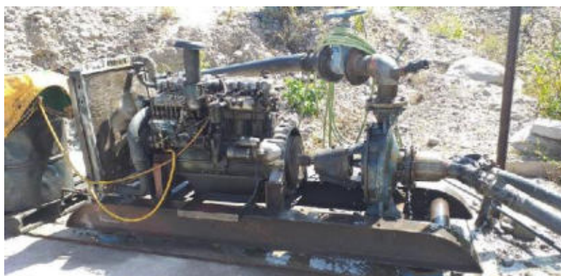
Ilustración 55. Bomba de combustible de la Concesión minera Zapote 1
