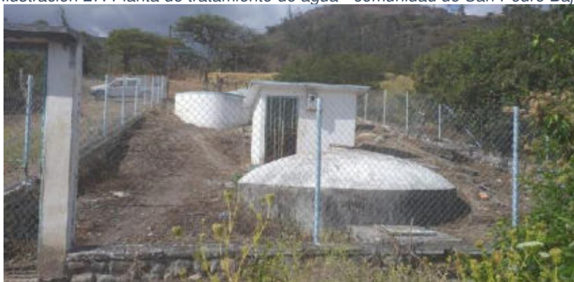
Ilustración 27. Planta de tratamiento de agua - comunidad de San Pedro Bajo
